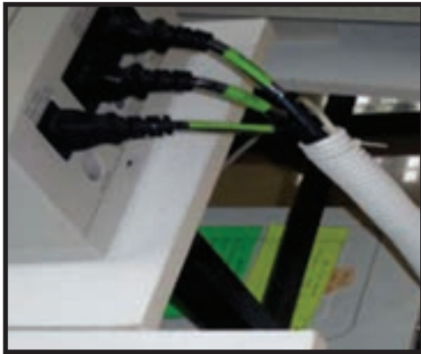
Soket Elektrik Diikat Rapi
